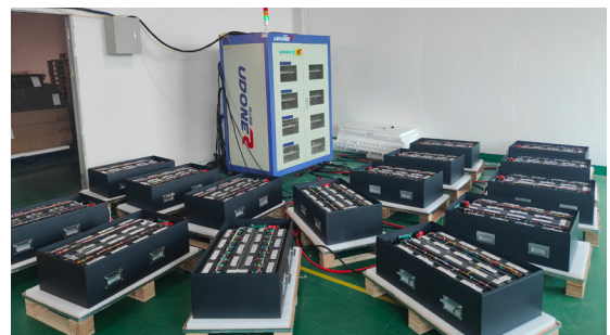
Battery test 电池测试
